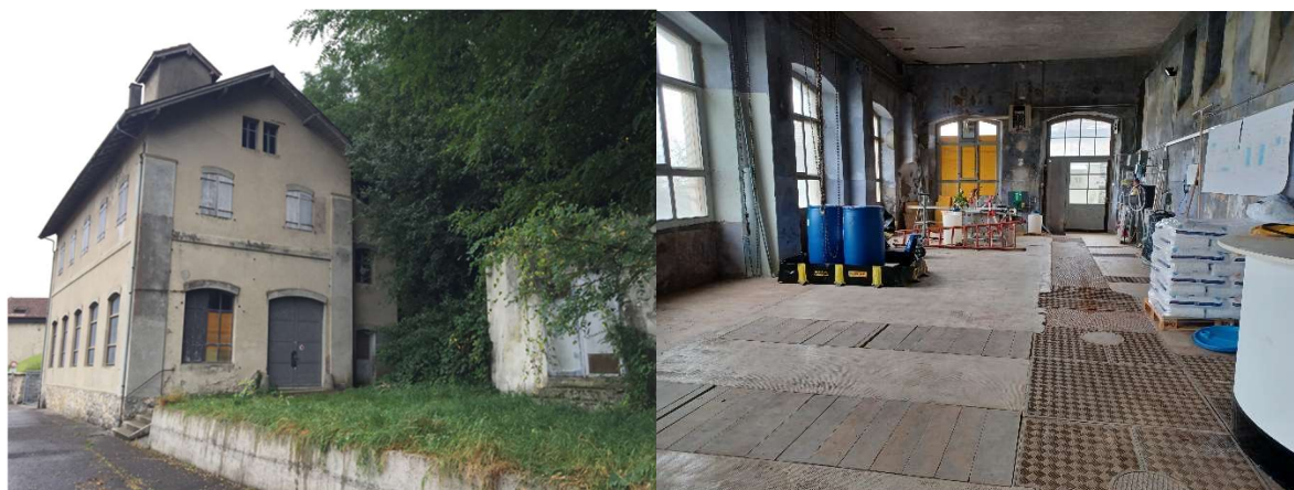
Figure 22 Ancienne station de pompage du Cossaux existante (extérieur et intérieur)
